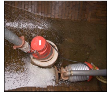
En Matadorpump håller undan läckvatten under slussbotten. Slampumpen (liggande) pumpar bort ev. kvarvarande fisk.
